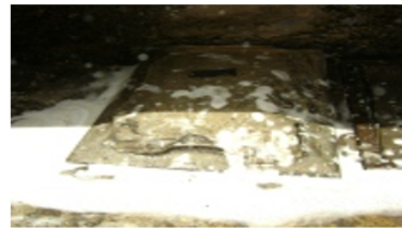
Foto No. 4: Presencia de agua con tensoactivos alrededor del pozo
